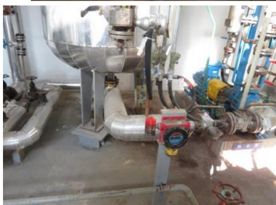
有害气体泄漏报警仪可燃气体报警仪现场照片
